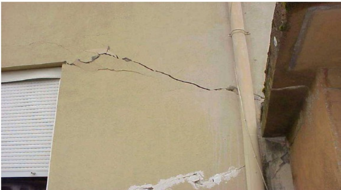
Fissuration sur bâtiment
